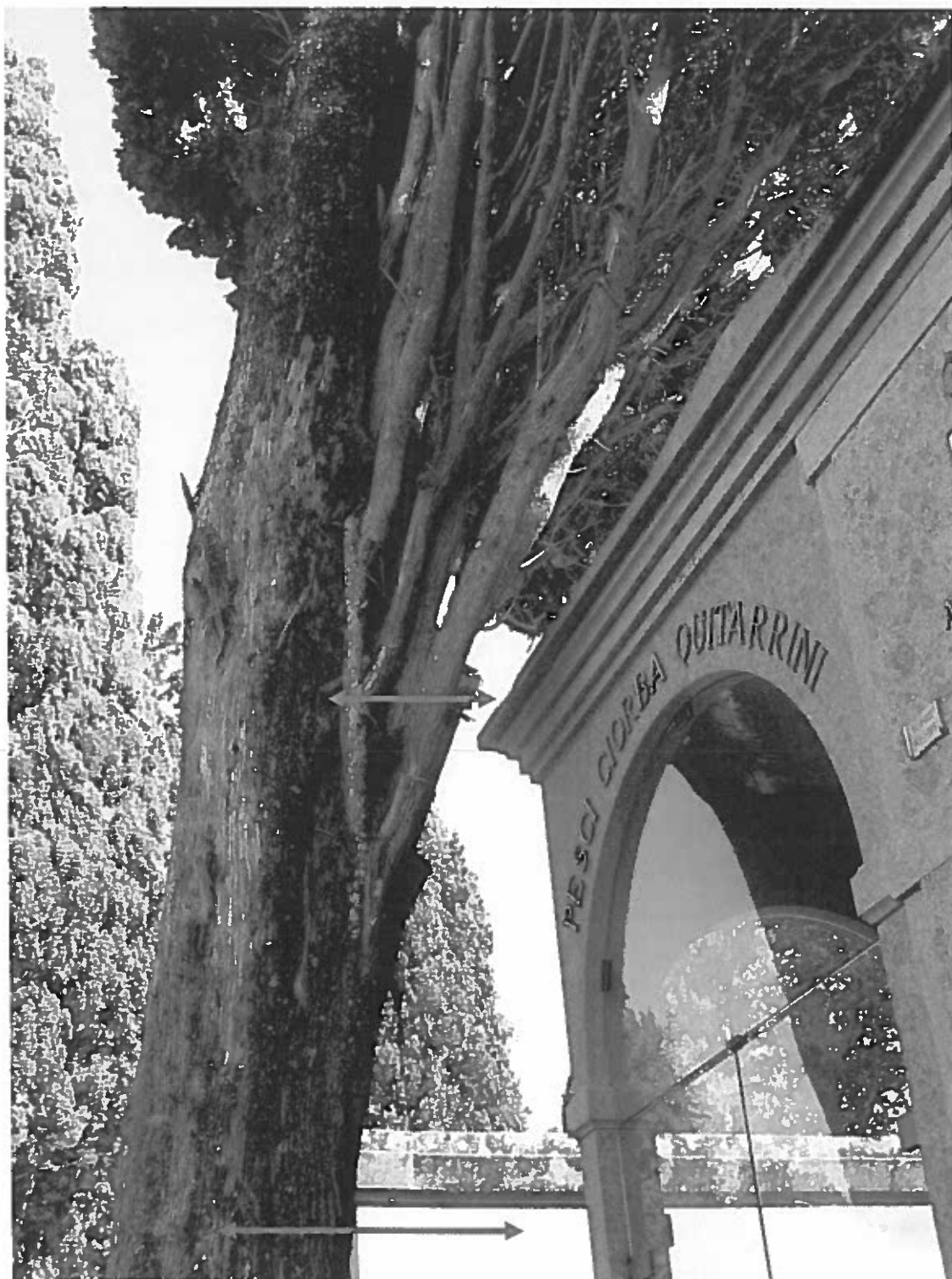
foto 6 – Cimitero Monumentale S.Lazzaro di Viterbo, esemplare n°151. Anche in questo caso la perdita del potere di ancoraggio dell'apparato radicale a portato ad un cedimento strutturale che ha sbilanciato l'intera struttura verso la vicina Cappella. Classe CPR 4.
