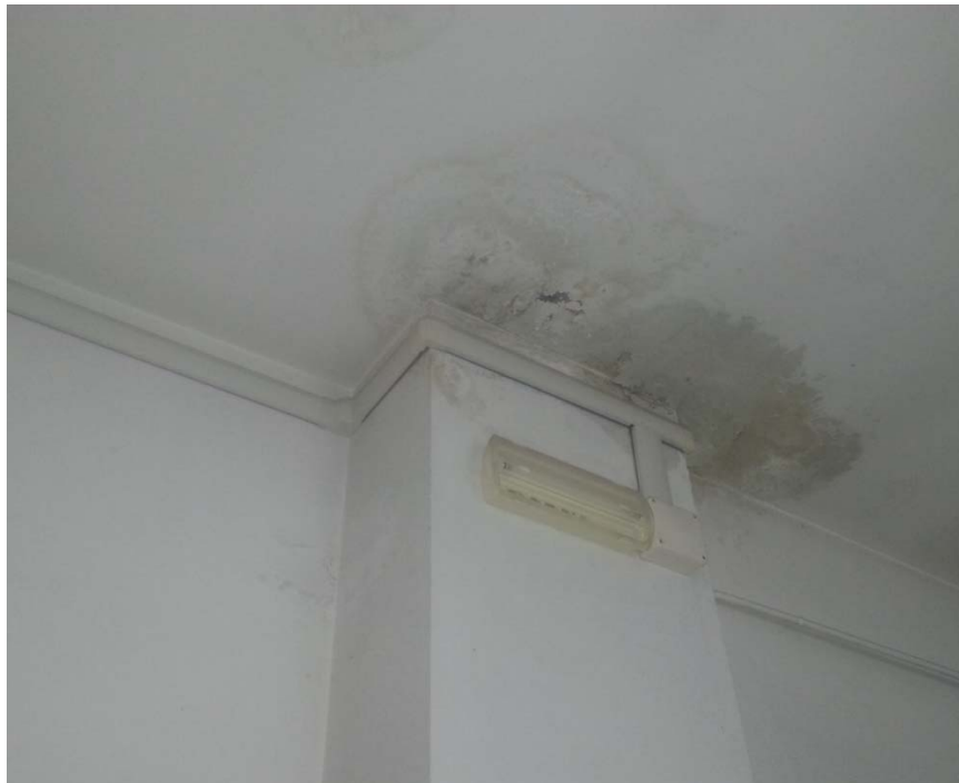
Figura 1. Infiltrazioni al terzo piano
